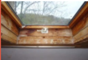
Absence de protection contre les infiltrations d'eau
