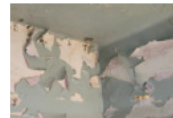
Peinture écaillée contenant du plomb
