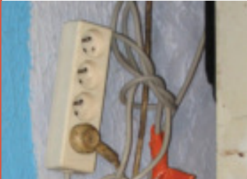
Installation électrique dangereuse
