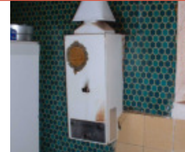
Absence de dispositif d'évacuation des gaz brûlés
